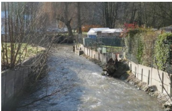
Romilly – Ripisylve et berge de rivière dégradée
